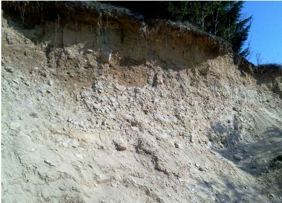
Obr. 61. Bývalá pieskovňa pri Východnej je v skutočnosti založená v starých, spodnopleistocénnych glaciáluálnych štrkoch.
